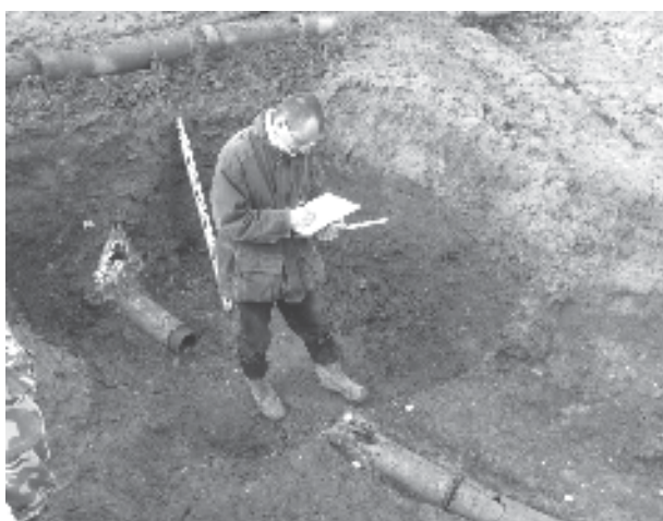
Obr. 62. Nám. Svobody (A093/2005). Dokumentace novověkého vodovodního potrubí. Platz Svobody (A093/2005). Dokumentierung einer neuzeitlichen Wasserleitung.
