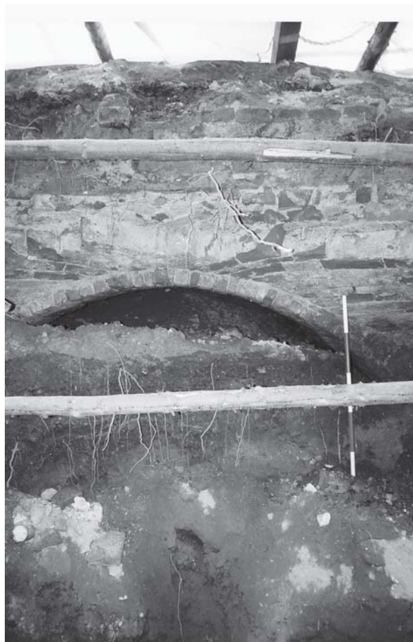
Obr. 95. Tuřany, jezuitská rezidence. Detail zavaleného sklepení.
