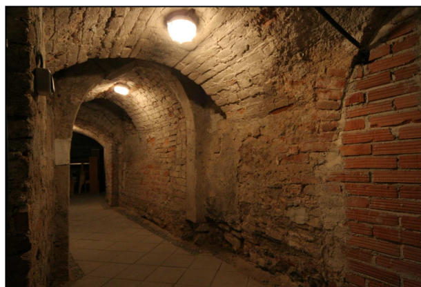
Obr. 13: Brno, Kobližná 4, pohled z místnosti 1.06 do chodbičky 1.08 pod někdejší průjezdem. Přibližně ve středu snímku je patrný druhotně vsazený kamenný gotický portál. Foto archiv Archaia Brno i.č. 3287-2005.
