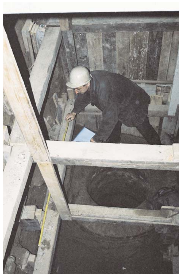
Obr. 10. Blok 49 (A004/2003). Dokumentace cisterny v sondě E1. Block 49 (A004/2003). Dokumentation der Zisterne im Suchschnitt E1.
