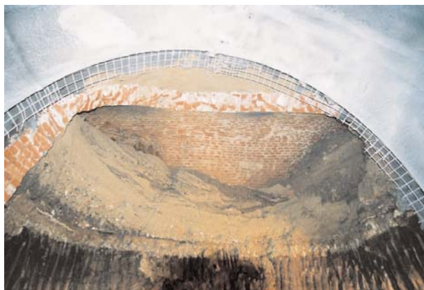
Obr. 7. Náměstí Svobody (A003/2003). Sklep zničený hlavní ražbou kolektoru. Náměstí Svobody (A003/2003). Ein durch die Haupttrasse des Kollektors vernichteter Keller.
